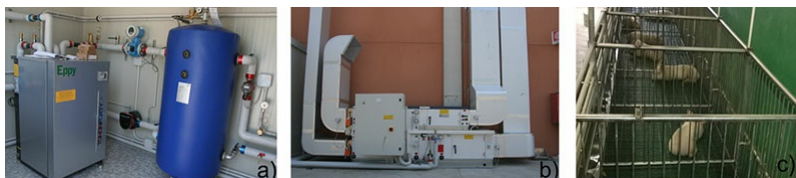
Fig.2 Impianto geotermico installato e costituito da pompa di calore (a), unità di trattamento dell'aria con recupero di calore (b) e sala di post-svezzamento suinetti (c).
